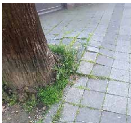
Questo il comportamento degli autobloccanti a causa delle radici dei tigli.
